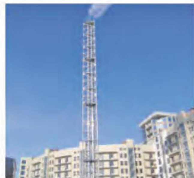
Коллективная котельная Высотой 48 м. трубы \varnothing 600/700
