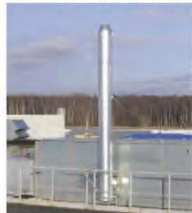
Модульная котельная в пос. Роцино труба \varnothing 250/350
