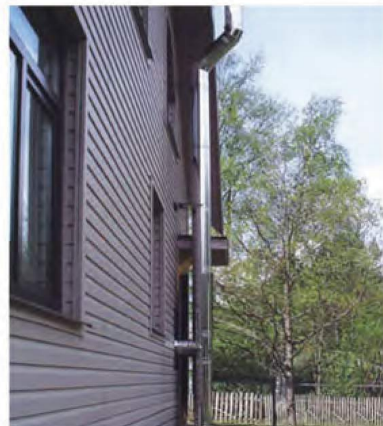
Частный дом. Зеленогорск трубы \varnothing 130/230
